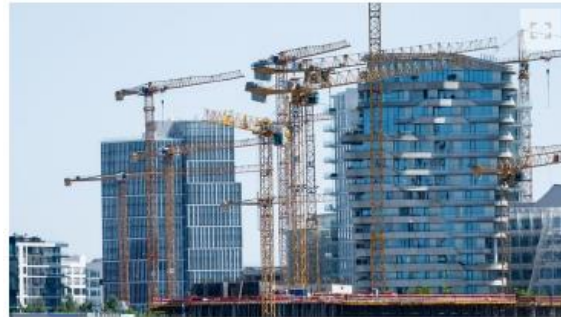
Kräne in der Hafencity: Hier soll ein großes - und nachhaltiges - Wohnhaus entstehen.
